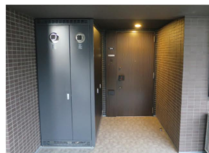
エネファーム設置状況(ザ・プレミアスカイ品川中延)
